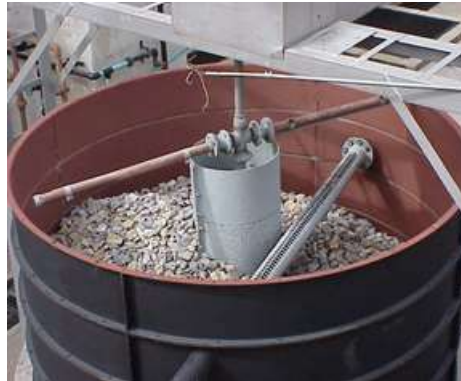
Figura VII.7. Lecho biopercolador de la Planta Experimental de Tratamiento de Aguas, UCV.
